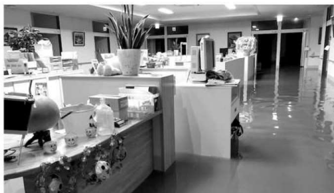
▲浸水した緩和ケア病棟
